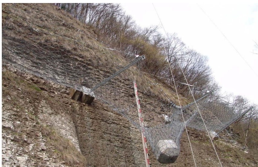
Слика 8.17: Флексибилне баријере од челичне мреже (rockfall net fences)
