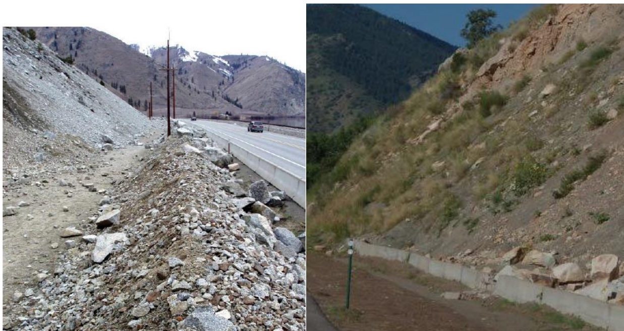
Слика 8.13: Конвенционална земљана баријера пружа заштиту аутопута од комада стијене малог одскока и мале ротационе енергије (лијево) и бетонска баријера са оштећењем од удара веће енергије ( десно)
